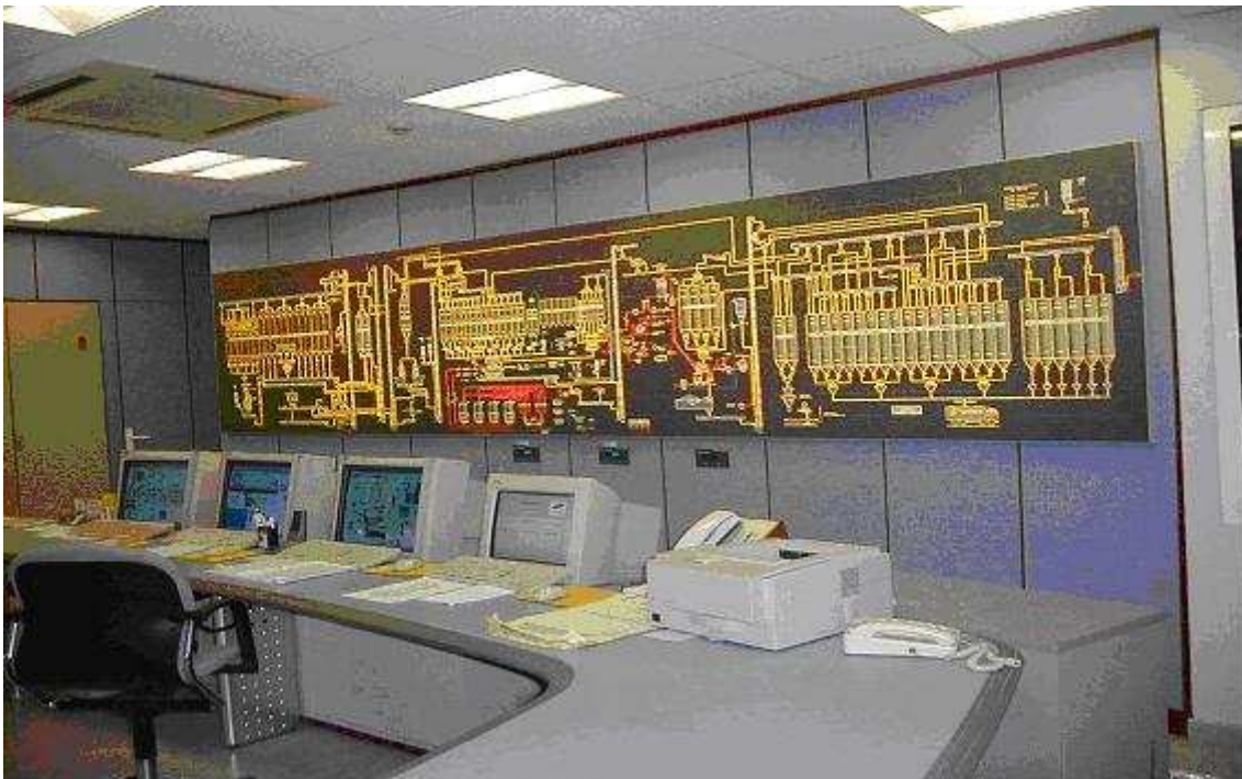
Figura 1.1. Exemple d'una sala de control de S.C.L. Agropienso.
